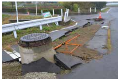
液状化によるマンホールの抜け上がり (山形県蔵王町円田)
