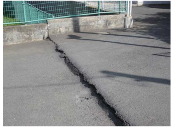
岡崎の谷戸田を埋めた上ノ入東公園に見られる路面とフェンス基礎の段差
